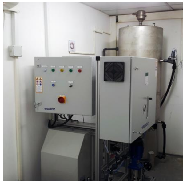
Figura 3. Ozonizador en el centro de I+D de la PTAR de Shafdan
