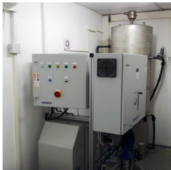
Figura 2 - ozonizador no centro de I&D da ETAR Shafdan
