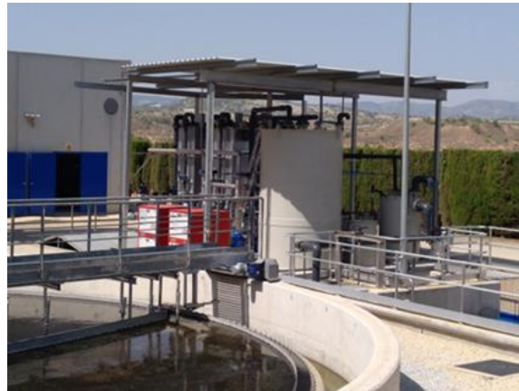
Planta de ultrafiltración
